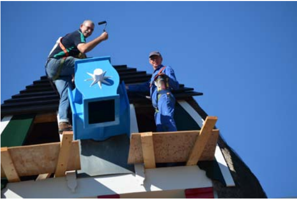
Rob en Ben hebben geen hoogtevrees en zijn voor de veiligheid ook goed gezekeerd voordat ze op de kap aan het werk gaan!
